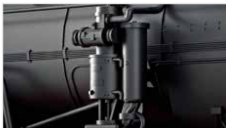
Speisepumpe Bauart VEB BBW KP4-250 mit Peters-Steuerung
